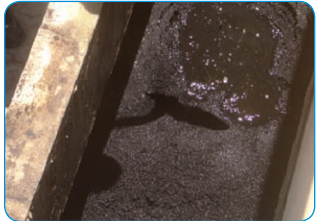
Vista do Filtro ao final. Filtro em Cerquilha - SP.
